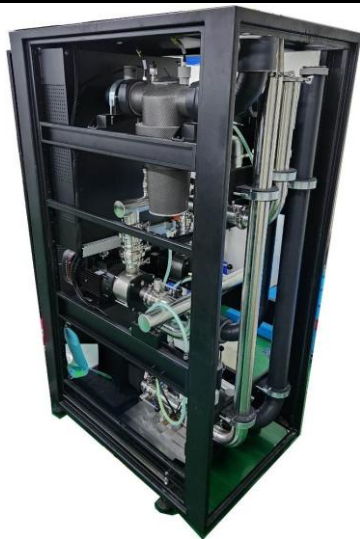
图10：列间 CDU 内部泵组、板换与管路总成
